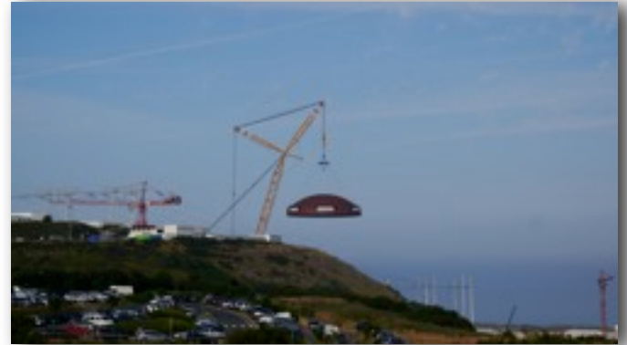
Pose du dôme du réacteur en juillet 2013 L'Autorité de sûreté y avait alors trouvé 15 non-conformités ! (1) EDF a fini par céder à ses injonctions et à la mise en demeure du Ministère du travail.
